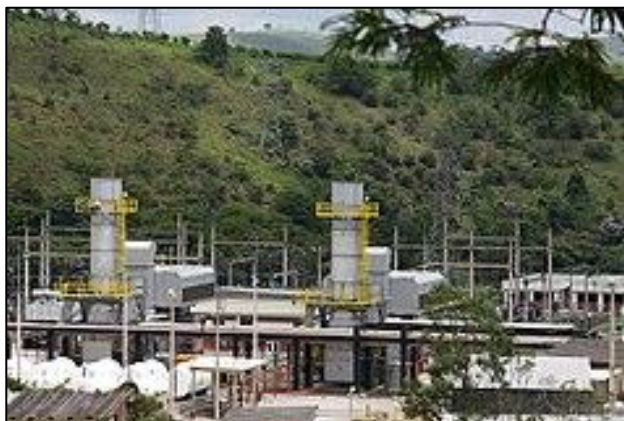
Figura 1.11 – Imagem fotográfica da usina termoeletrica de Juiz de Fora – MG.
